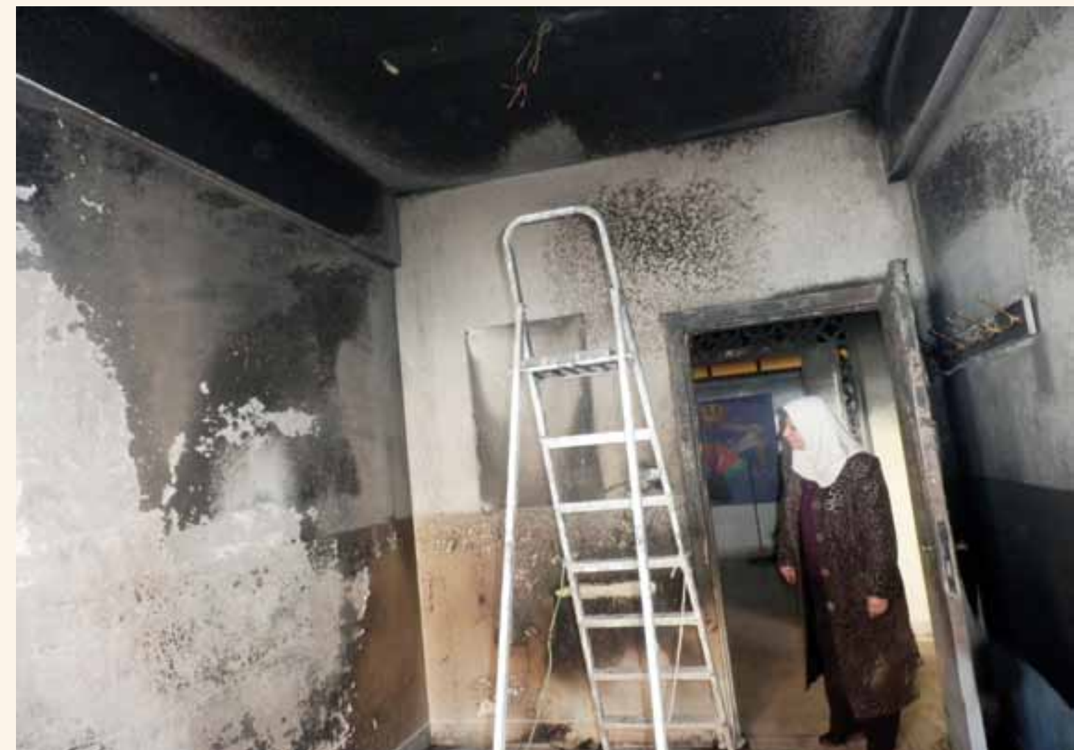
غرفة مساعدة المديرية والتي حدث بها التماس الكهربائي
